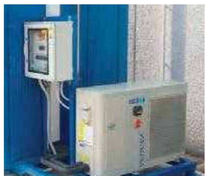
UNITA' MOTOCONDENSANTE ESTERNA CON QUADRO DI COMANDO
