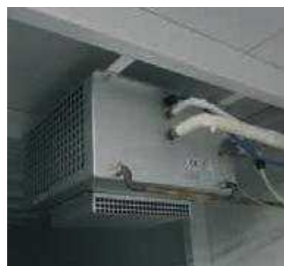
AEROEVAPOREATORE INTERNO IMPIANTO DI CLIMATIZZAZIONE
