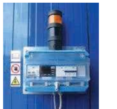
CENTRALINA DI COMANDO IMPIANTO ELETTRICO
