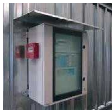
CENTRALINA DI UN IMPIANTO ANTINCENDIO
